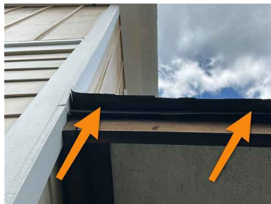
Excessive Drip Edge
