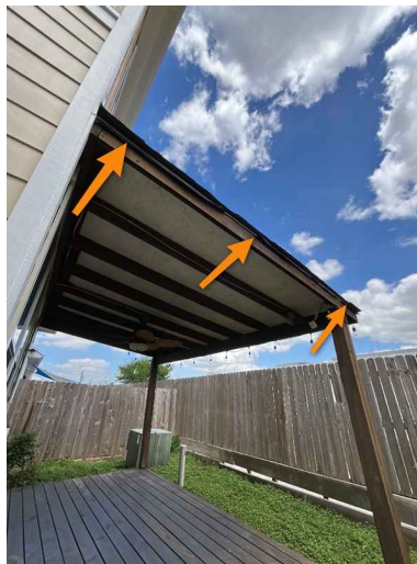
Excessive Drip Edge
